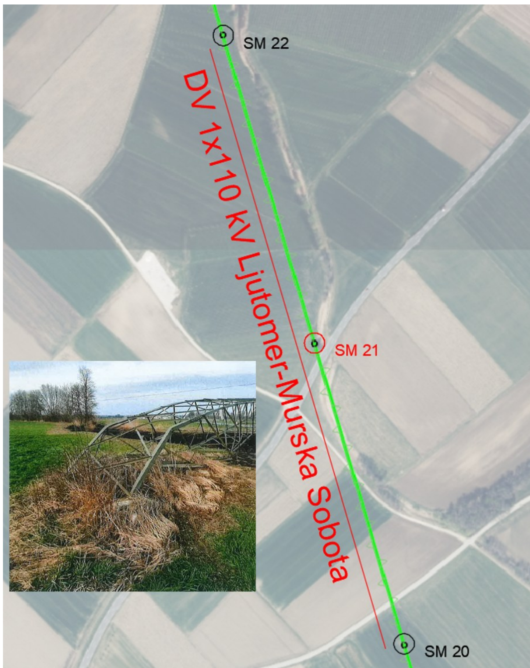
Slika 1 – Slika dela trase DV 110 kV Ljutomer–Murska Sobota z rdeče označenim porušenim stebrom št. 21
